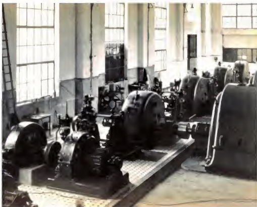
Vista de la sala de turbinas de la central de Cabdella.
