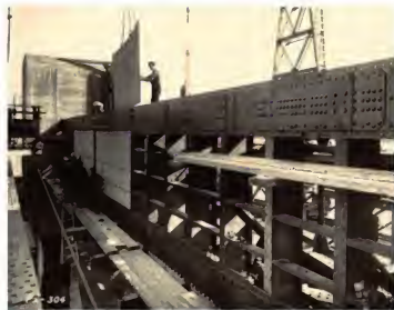
Zona de la presa. Varias vistas del estado del montaje de las compuertas.
