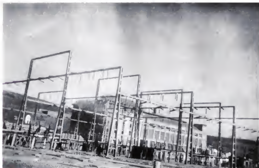
Parque de alta tensión con central al fondo.
