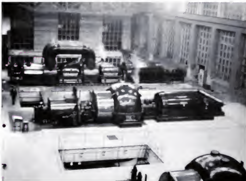
Sala de turbinas
