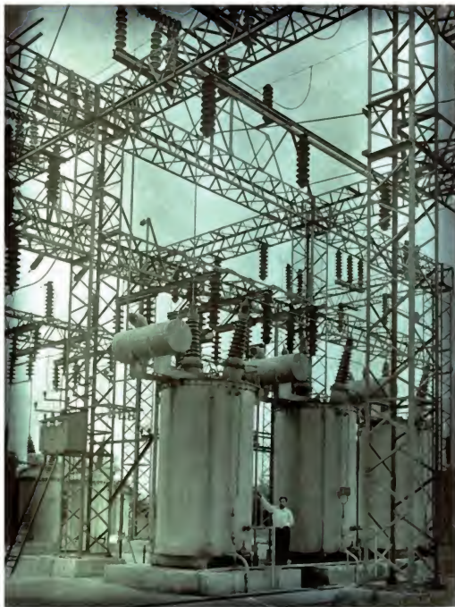
Autotransformador de 90-100 kV. La Pobla de Segur, Lérida.
