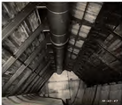
Vistas interiores de los mecanismos de compuerta de la presa de Flix en Tartagosa
