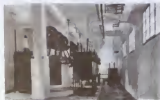
Sala de Máquinas 1910
