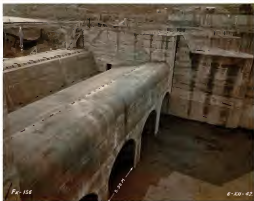
Zona de la presa, vista de la parte interior de la compuerta automática N° 8
