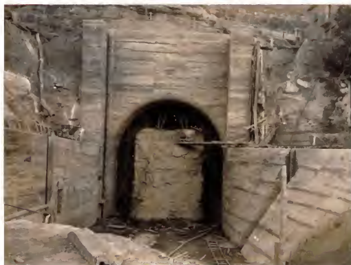
Zona de la presa, entrado al túnel de riego, el bloque de piedra interior queda como soporte de construcción durante la excavación
