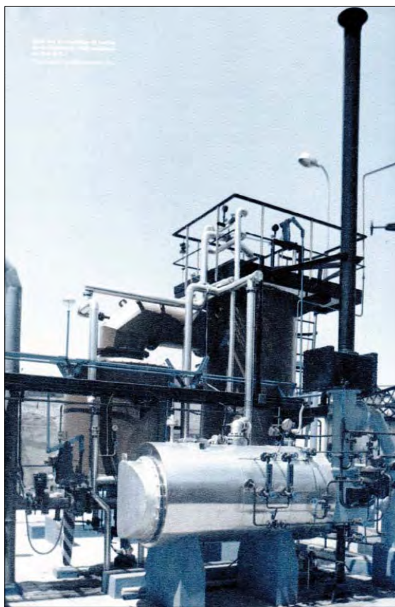
Equipos de reformado catalítico de la fábrica de gas de Vilafranca del Penedès (Gas Penedès: 1994: 34).
