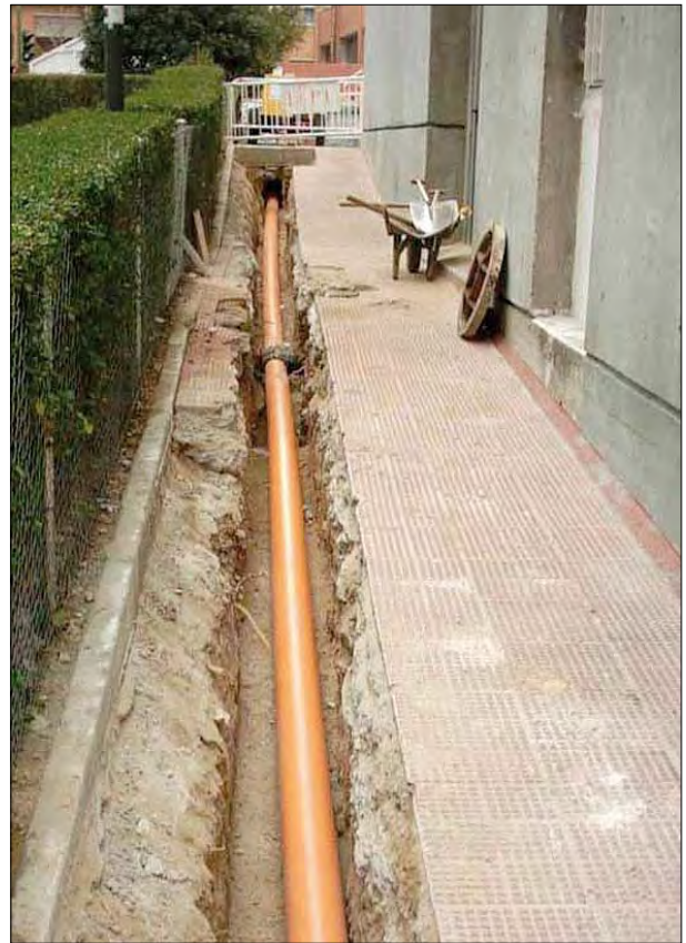
Tubería de polietileno PE100 para media presión ( Gas Natural S.D.G.).
