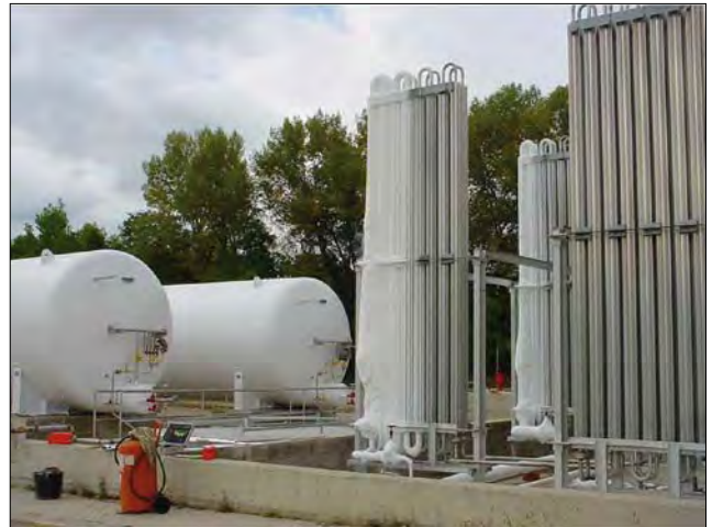
Planta satélite de gas natural licuado situada en Puigcerdà. Se pueden observar los depósitos y los intercambiadores de calor gas-aire. Estos en su primer tramo han congelado la humedad ambiental a causa de la extrema temperatura del gas licuado que circula por su interior para ser calentado hasta la temperatura ambiente. (Gas Natural S.D.G.).
