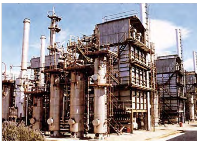
Equipos de reformado catalítico SNAM de la planta de Manóteras, Madrid (Gas Madrid, 1996: 37).
