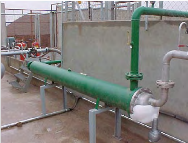
Regasificador de GNL por agua caliente (SEDIGAS).
