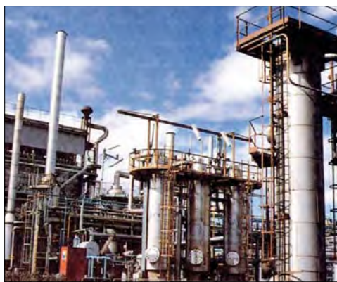
Equipo I de reformado catalítico Koppers de la planta de Manóteras, Madrid (Gas Madrid, 1996: 52).
