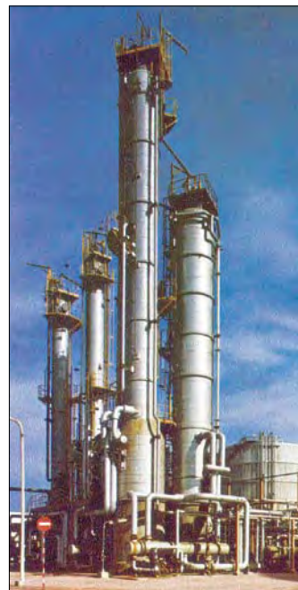
Torres de fraccionamiento del GNL para obtener propano y butano, 1969 (Gas Natural S.A.).
