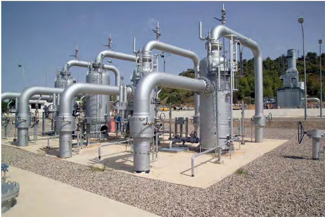
Estación de compresión de Tivissa (Enagás, S.A.).
