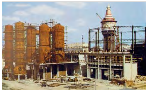
Fábrica de la Barceloneta. Instalación de los equipos ONIA-GEGI de producción de gas de nafta (AHFGNF).
