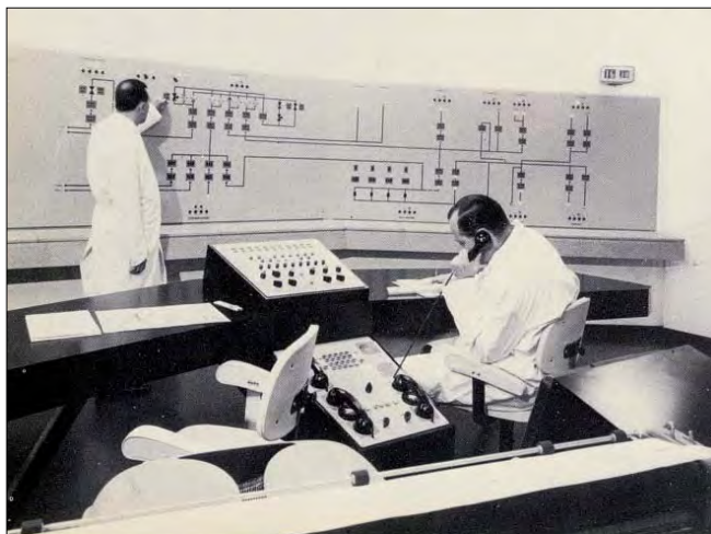
Centro de control de fábrica de gas (Catalana de Gas y Electricidad, S.A., año 1969).
