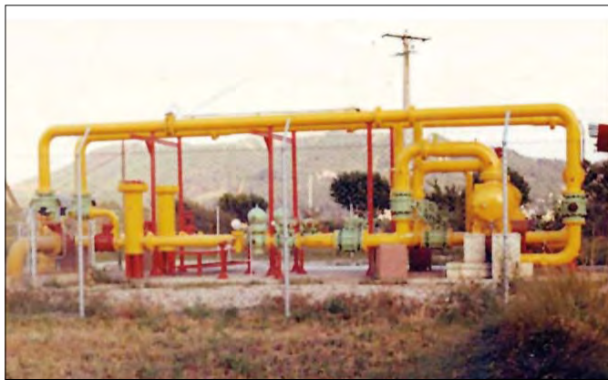
Estación reguladora de Cerdanyola, una de las primeras que se construyeron para la distribución de gas natural sobre la red de 36 bar de Barcelona. Desde esta instalación se facilitó el cambio de gas de las redes Sabadell y Terrassa entre 1971 y 1973 (J.Mata).
