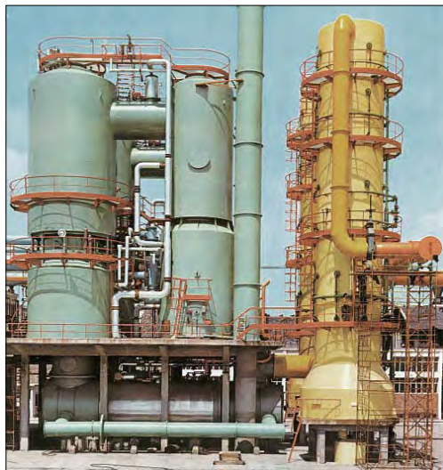
Imagen de las cámaras de "Reforming" y combustión de la planta de San Martí (AHFGNF).
