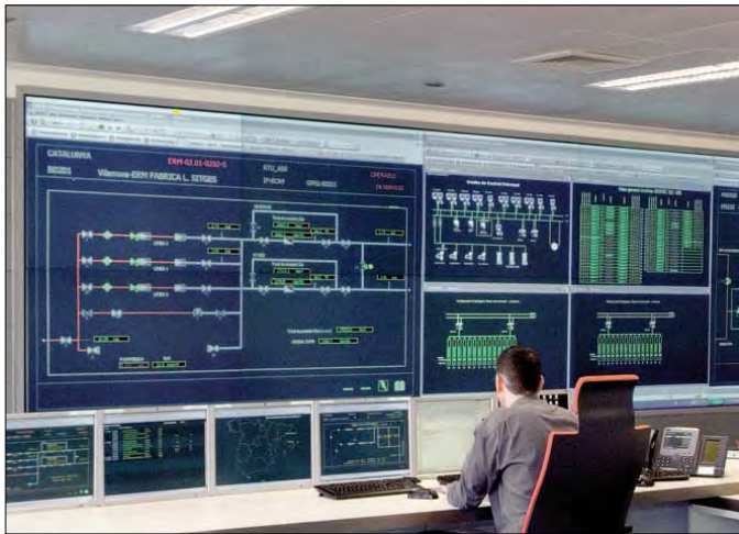
Centro de control de distribución de Gas Natural en Barcelona, año 2008 (Gas Natural SDG, S.A., año 2008).
