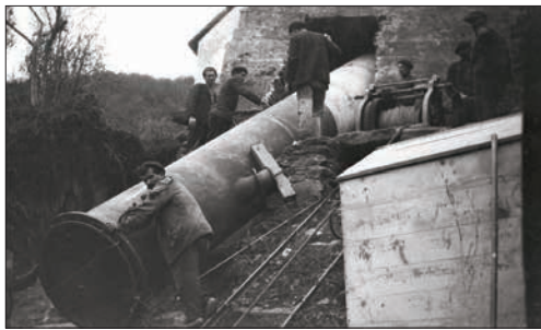
Colocación de la tubería de carga en la central de Ventureira (A Capela), en el río Eume. Año 1903. Fuente: Arquivo do Reino de Galicia. Colección fotográfica. Signatura 388.
