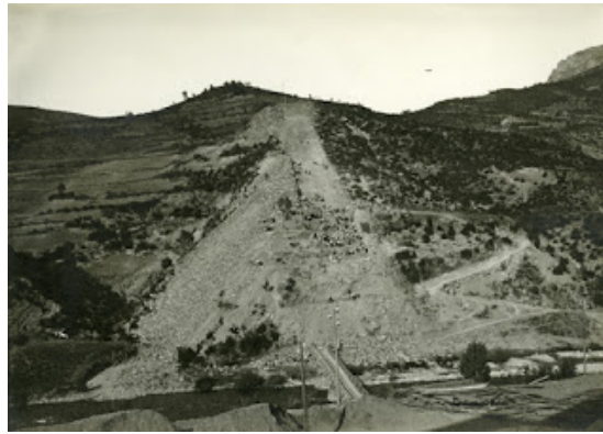
Excavación en la ubicación de las tuberías de presión. Seira. 22 de agosto de 1913.
