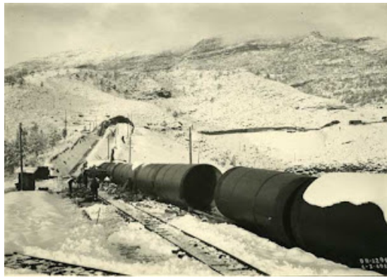
Las virolas de la tubería esperan, cubiertas de nieve, su colocación. 1 de marzo de 1918
