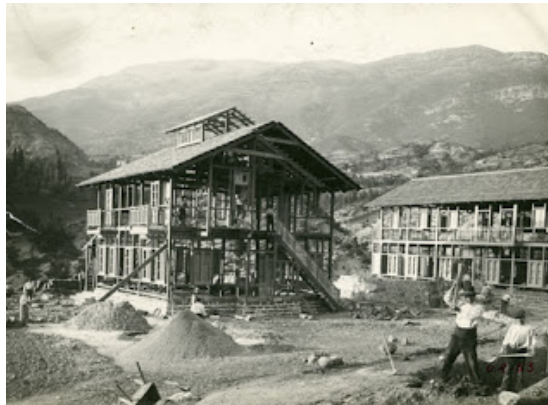
Construcción del edificio de oficinas. A su derecha la residencia de empleados. Seira. 10 de septiembre de 1913.
