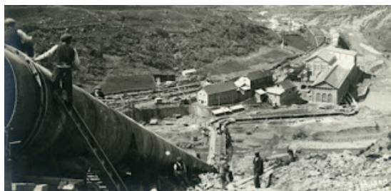
La parte final de la tubería, originaria de Zurich, es la última que ha llegado y en los meses de peor tiempo. Cada tubo que se coloca de la misma es alineado y sujetado mediante una gran cantidad de gruesos remaches. Seira. 6 de abril de 1918.
